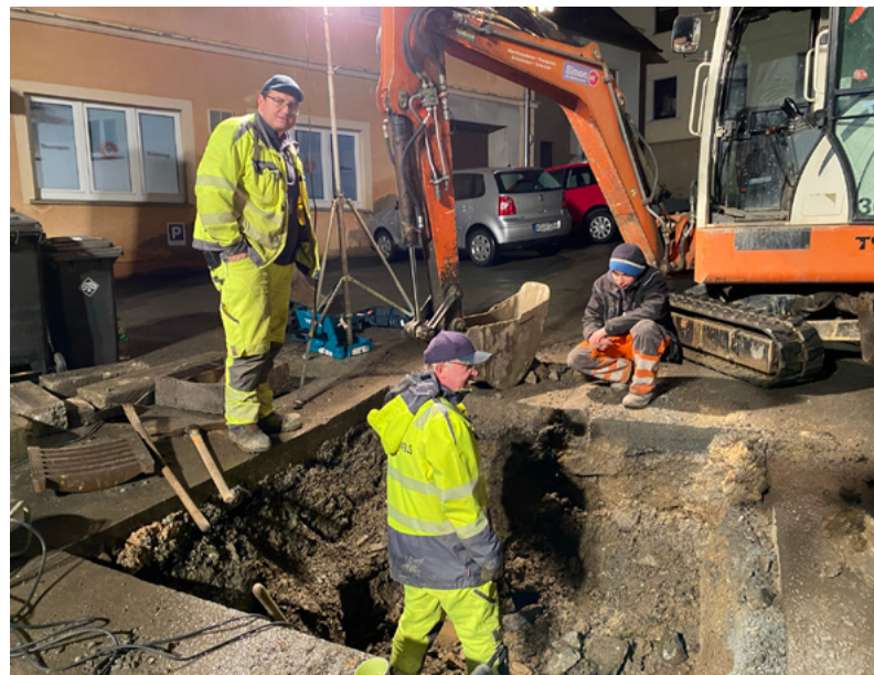
Abb.: Rohrbruch am Schloßberg
